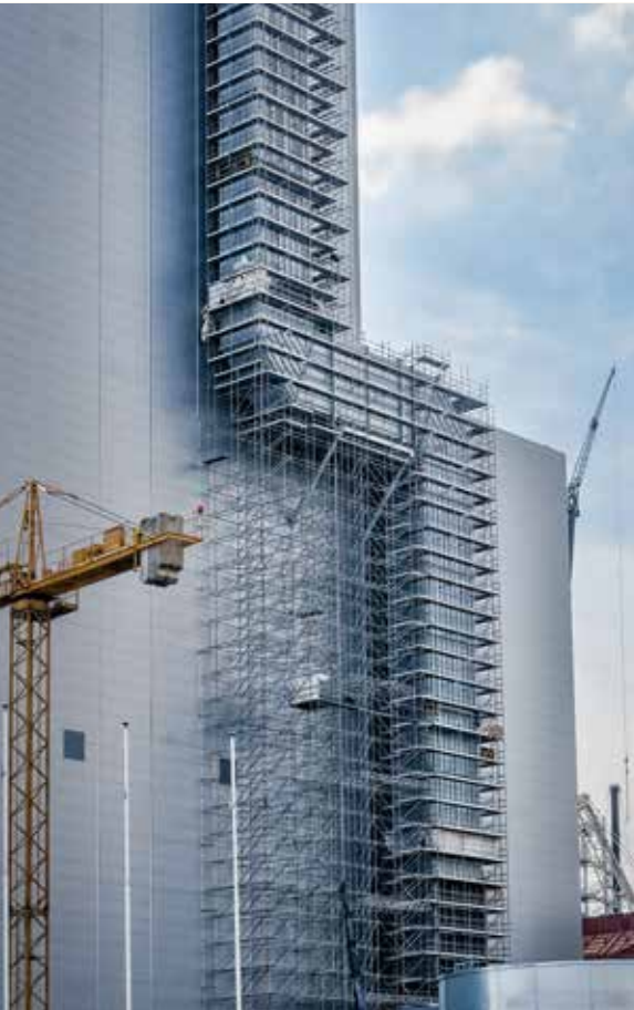
Ponteggio privo di legno in centrale elettrica
