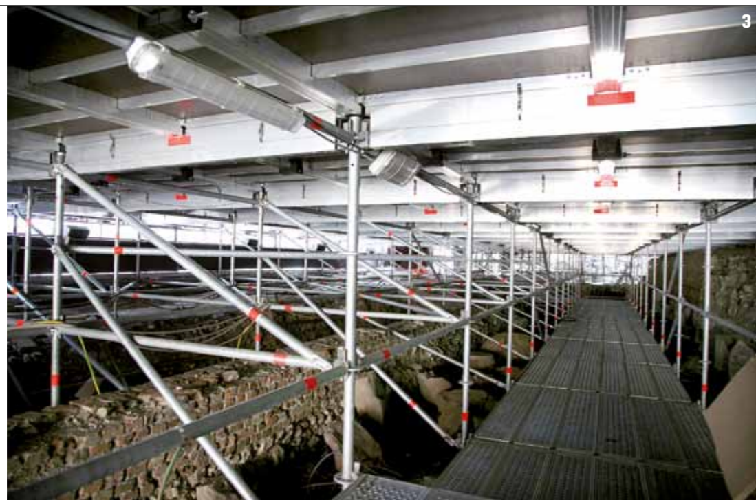
3_ La passerella realizzata sotto e avanti il boccascena che consente le manutenzioni, il passaggio dei cavi ed il passaggio degli artisti.
