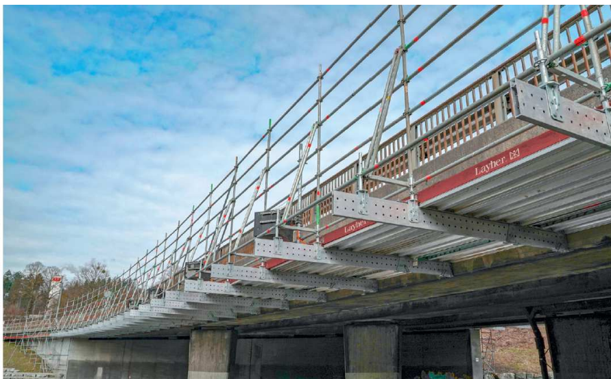
Trave Flex per piattaforma di lavoro alle estremità di un ponte - altezza utile di passaggio per camion mantenuta
